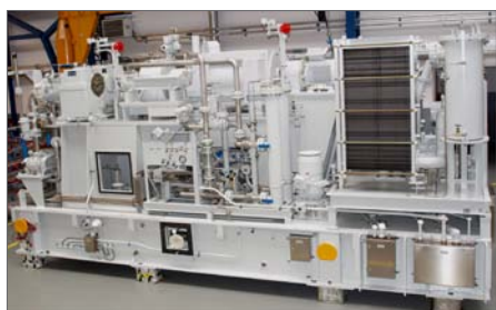
Fot. 1. Układ pomocniczy turbiny gazowej
